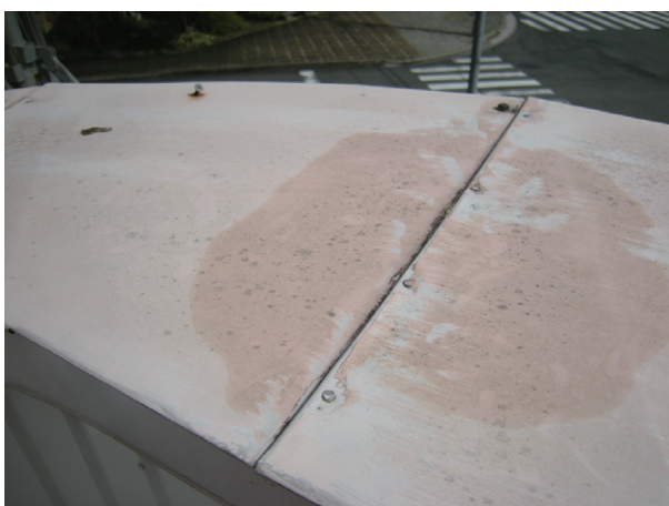
〔写真1〕雨漏り招く危険な納まり
