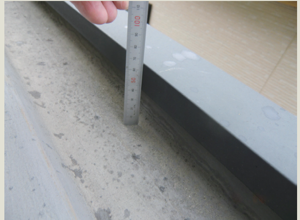
〔写真8、図6〕 シート防水の立ち上がりが不足
