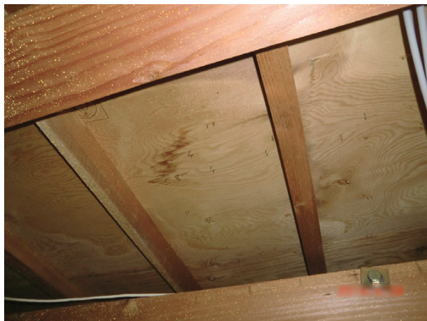
片流れ屋根の棟部から浸入した雨水は、傾斜した野地板に沿って流れ、室内での雨漏りにつながった。2階浴室の天井にある点検口を開けて確認したところ、写真のような染みを発見した（写真：41ページもタウ・プロジェクトマネジメント）
