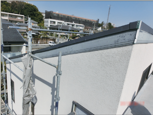
〔写真7、図5〕 笠木と破風板の隙間から雨水浸入
