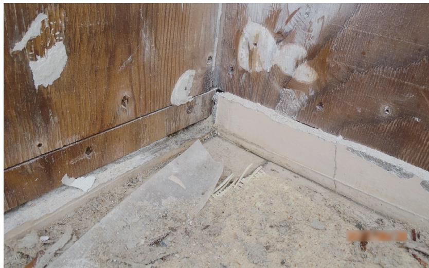
(写真4) 手すり壁の立ち上がりはたった10mm
